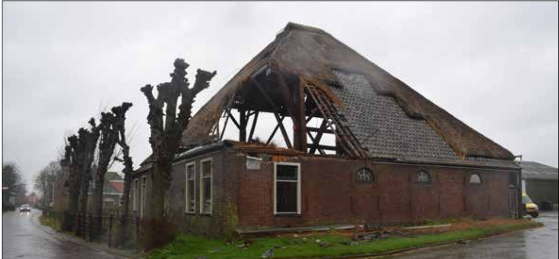
De stormschade van de stolpboerderij aan De Weere 52.
